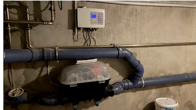
Elektrische Rückstausicherung (Klappe) für fäkalienhaltiges Abwasser
